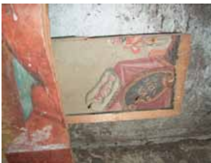
Bruneck, Boden im Souterrain einer Jugendstilvilla: Ausflickung im abgetretenen Bereich. Fotoarchiv Pescoller Werkstätten
